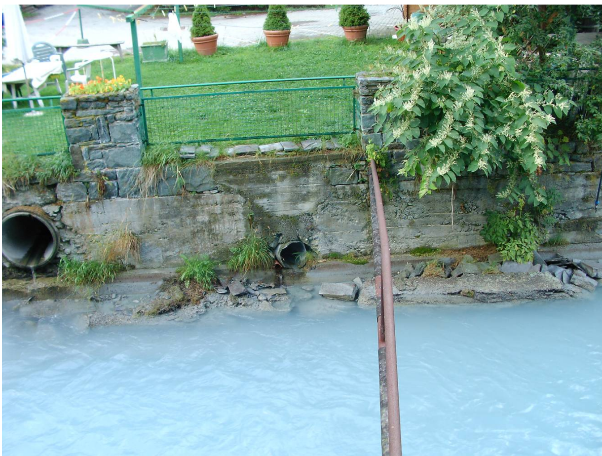
Foto 2 - scarichi da far confluire nel collettore
