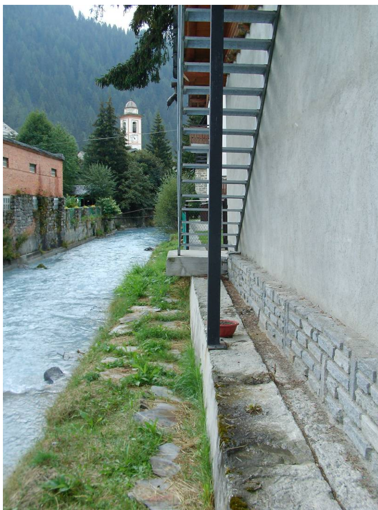
Foto 1 - tratti di arginature da consolidare con paratie
